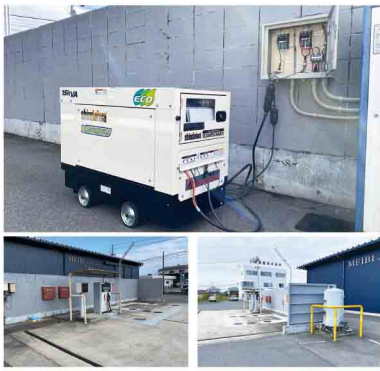
(写真上)今回導入した自家発電機。敷地内にある給油施設(左下)と井戸(右下)。
