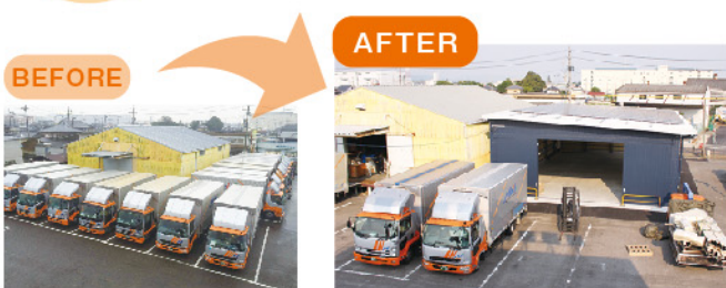
新倉庫が建つ前は駐車場でした。(※黄色い倉庫の横に建設しました)
