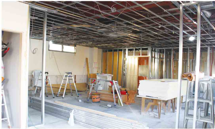
本社1階の工事の様子です。これからこの1階が大変身する予定です。
